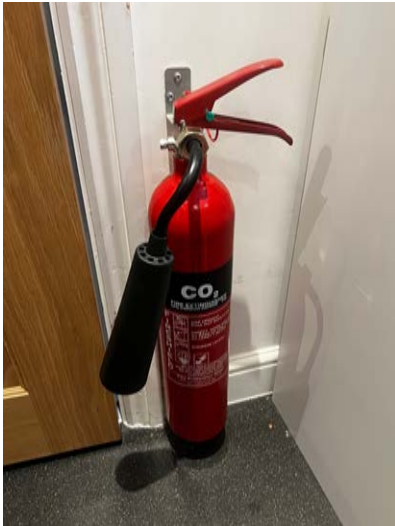
Wall hung CO2 Fire Extinguisher
